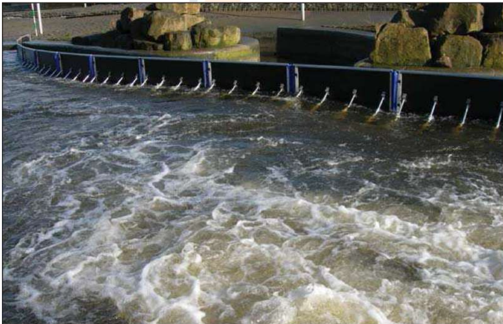
Figura 21 – Dique da AquaFence em uso
